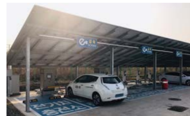
DC차데모 양방향 전기차 충전기 (2기) / (충전 : 50kW / 방전 : 20kW)
